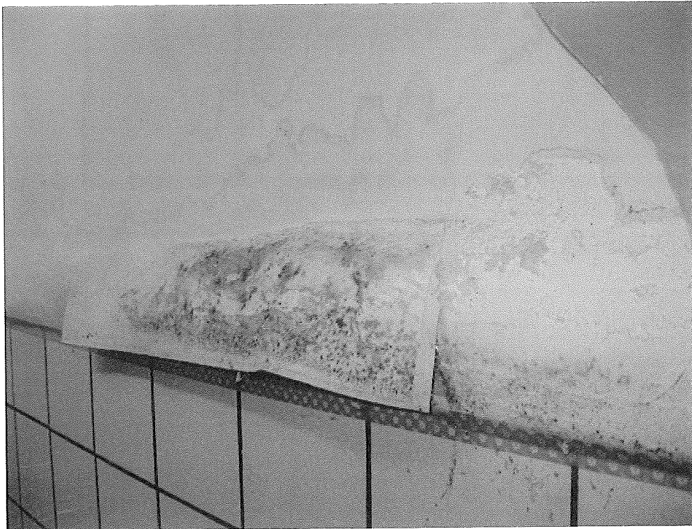
Abb.9 Ausblühungen, Schimmel Südwand EG
