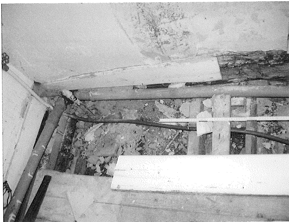
Abb.10 geschädigter Deckenbalken Raum 1
