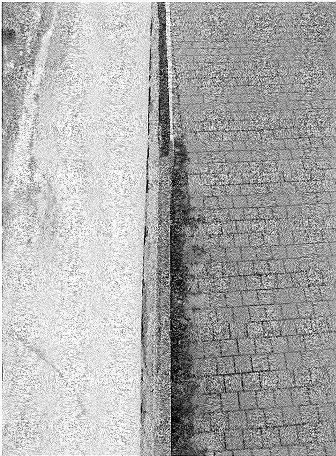
Abb.7-3 abgelöster Putz Nordseite
