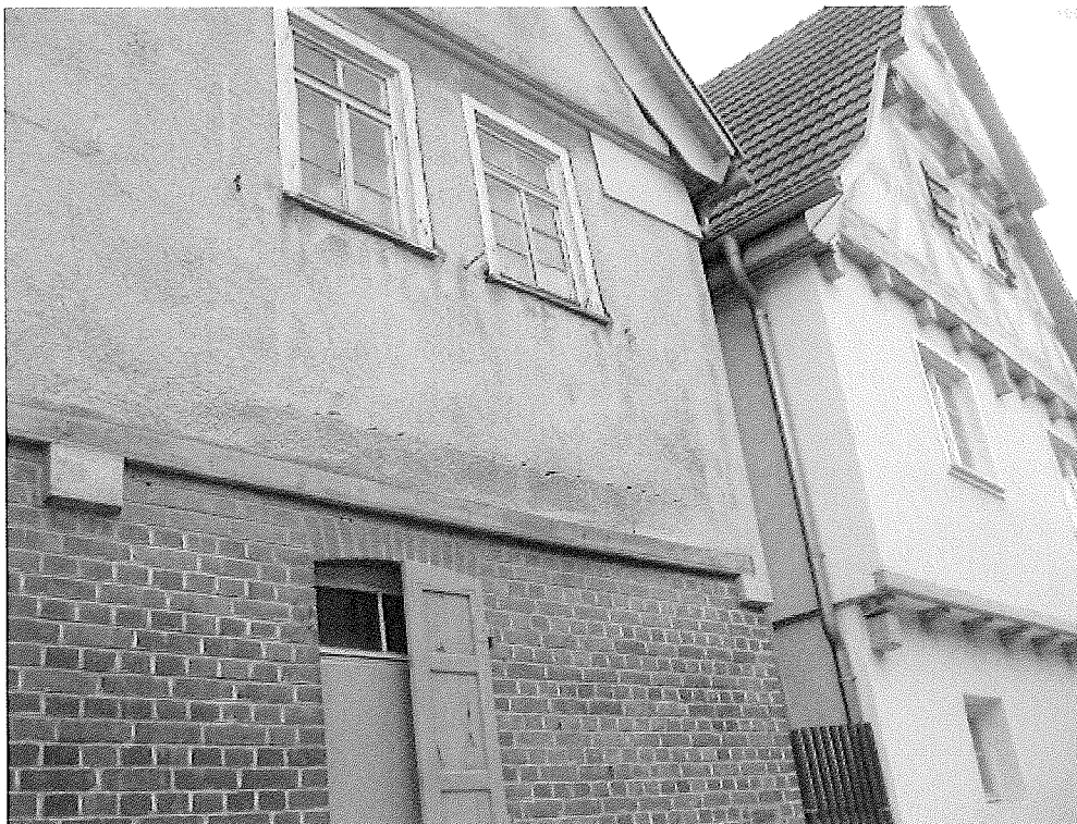
Abb.7-2 abgelöster Putz Nordseite
